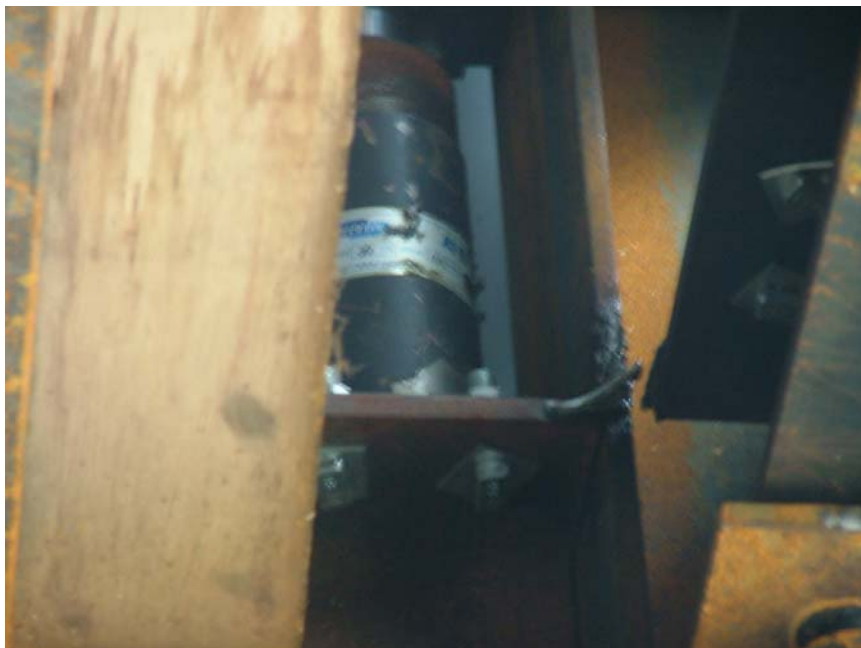
圖 12 層間變位設備
