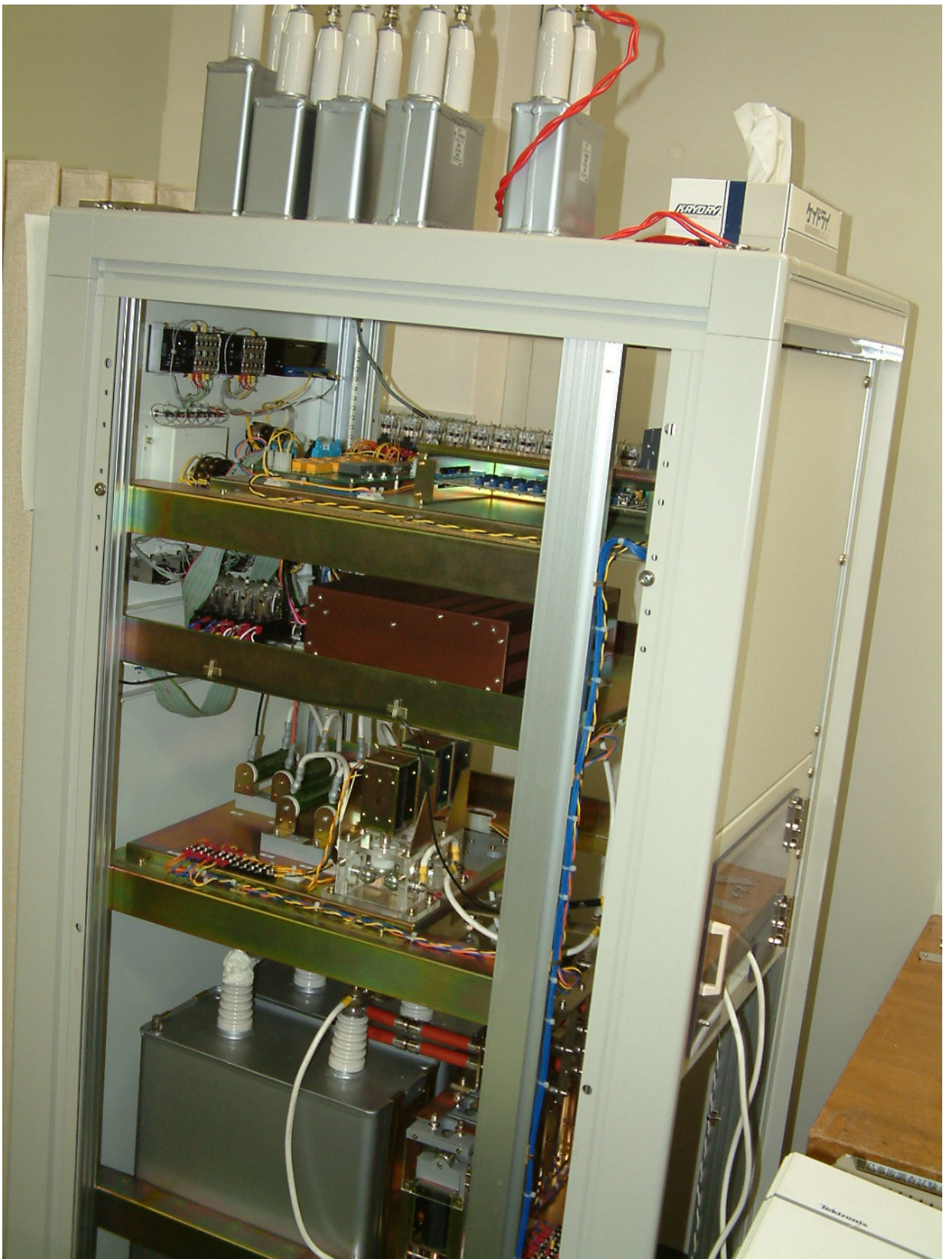
圖 17、脈衝電壓測試設備
