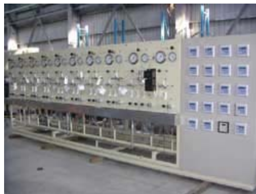
圖二. 各式分析儀錶安裝在取樣調整盤上
