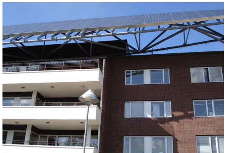
圖五 Sege Park 老人住宅利用太陽能發電
