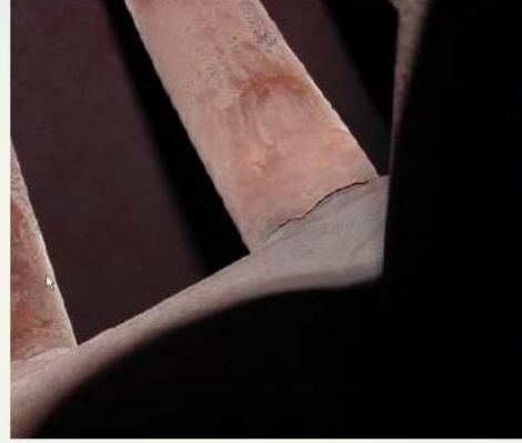
Horizontal gas path HRSG
