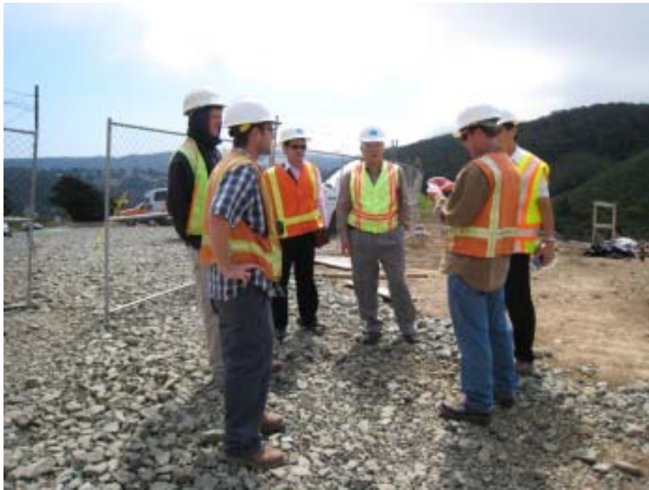
橋梁資深工程師 Mr. Thomas Grey 現場說明加州舊金山 Devil ' s Slide 地滑整治工程之橋梁施工情形
