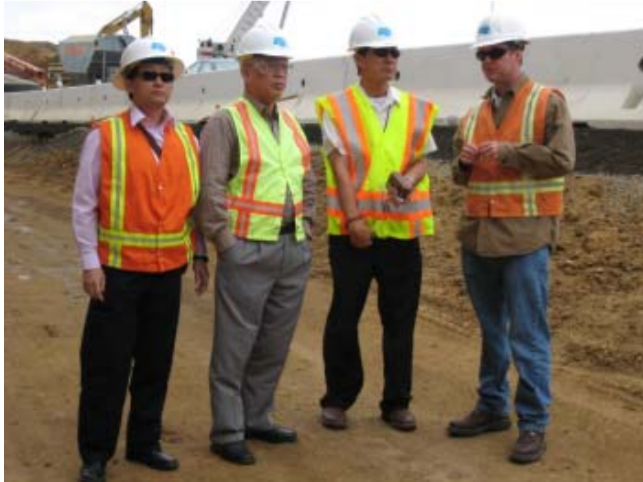
橋梁資深工程師 Mr. Thomas Grey (右一)現場說明加州舊金山 Devil ' s Slide 地滑整治情形
