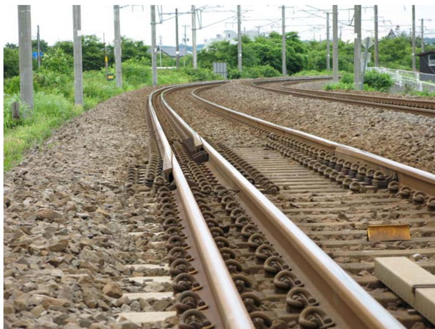
照片 19 三線軌及鋼軌伸縮接頭
