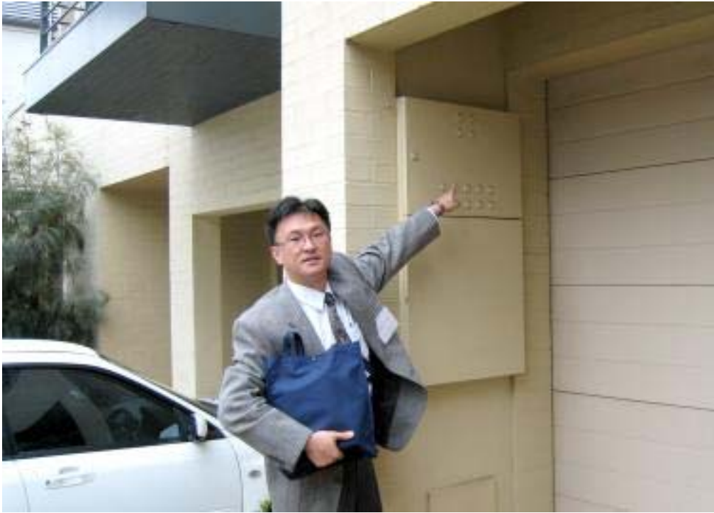
圖2.1.9裝置電力調節器(Inverter)的配電箱
