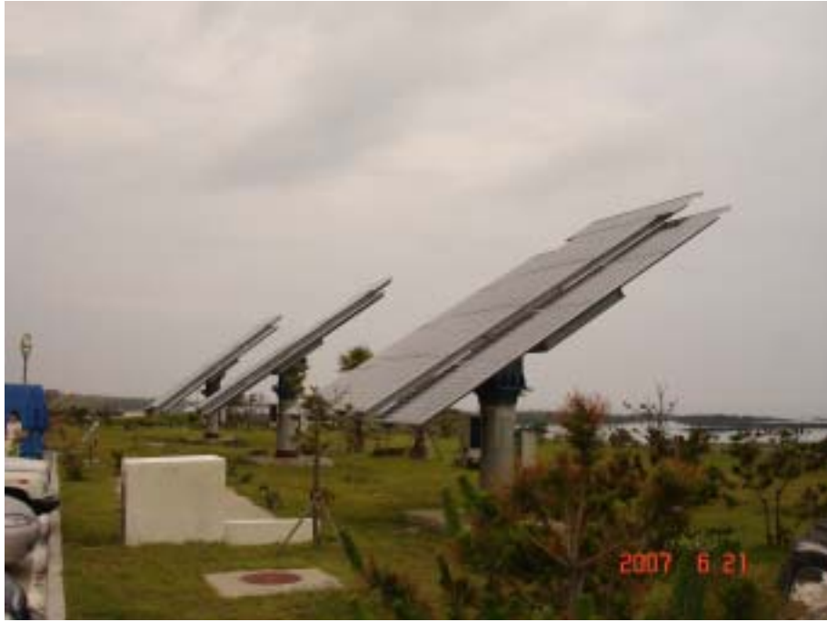
圖三 太陽能發電設備
