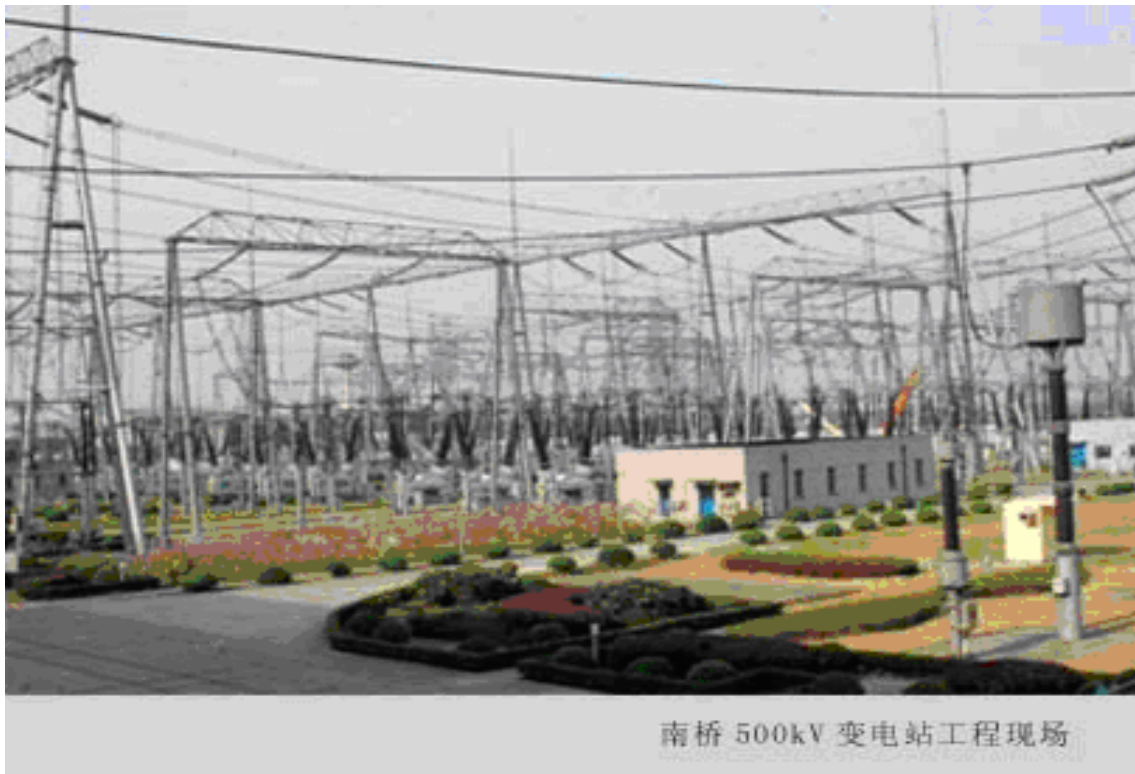
圖二十五：南橋 500kV 變電站
