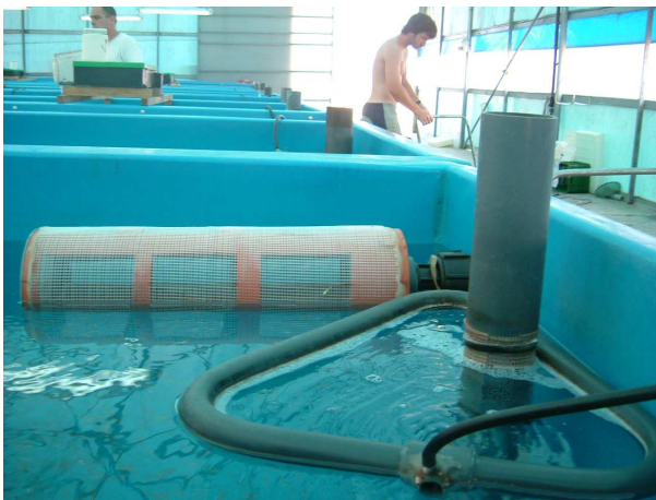
槽上架自動投餌機及簡易蛋白質浮除裝置
