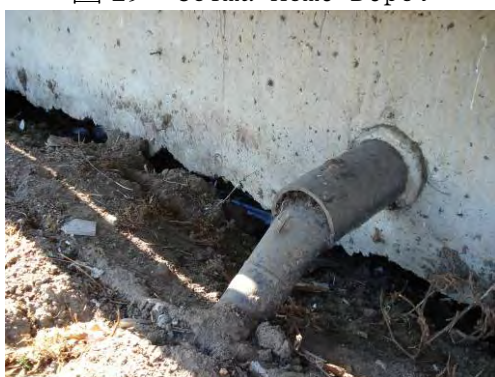
圖 31 掩埋垃圾沉陷情形
