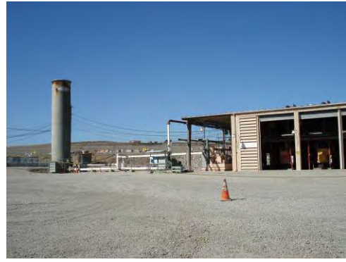
圖 38 沼氣發電設施
