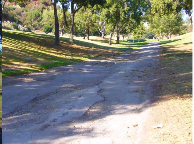
路面為典型的掩埋場沈陷
