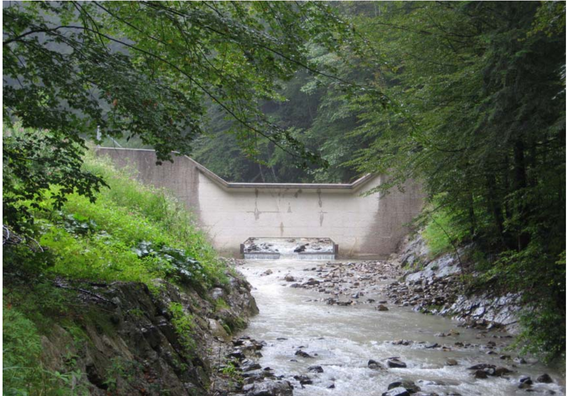
照片 15 底部開口式攔砂壩可避免阻斷水中生物通道
