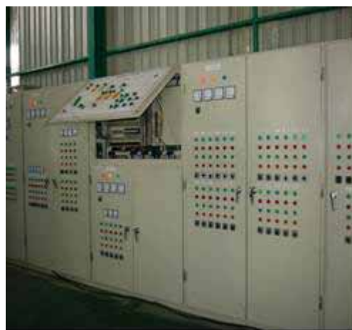
(調配廠中央控制室)
