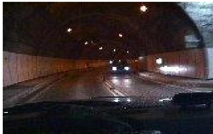
圖 4-1.6 隧道照明設備
