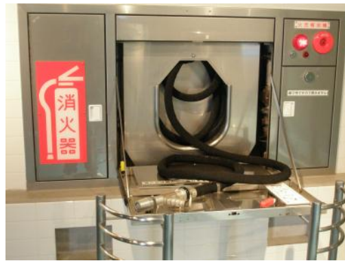
圖 4-2.18 模擬滅火設備
