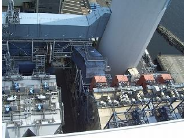
煙道氣脫硫系統(右上角為煙囪)俯視
