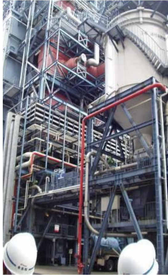
煙道氣脫硫裝置
