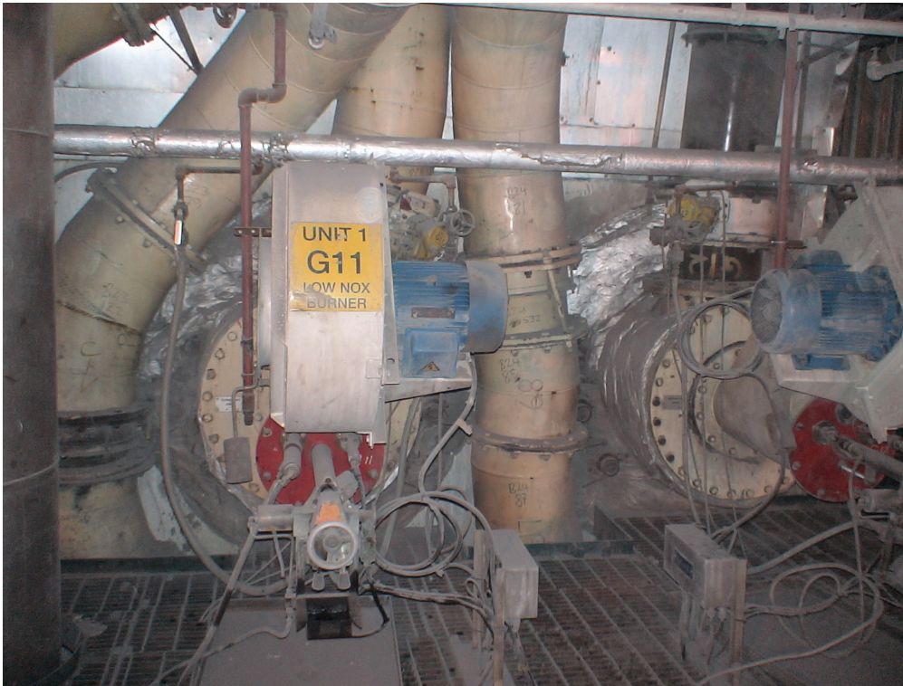
圖七：Ratcliffe-on-Soar 電廠鍋爐房之燃燒器
