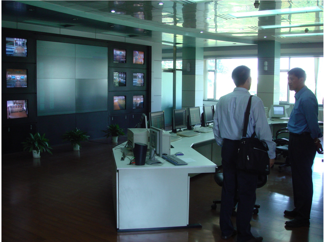
圖 7 北京第九水廠操控及監控中心
