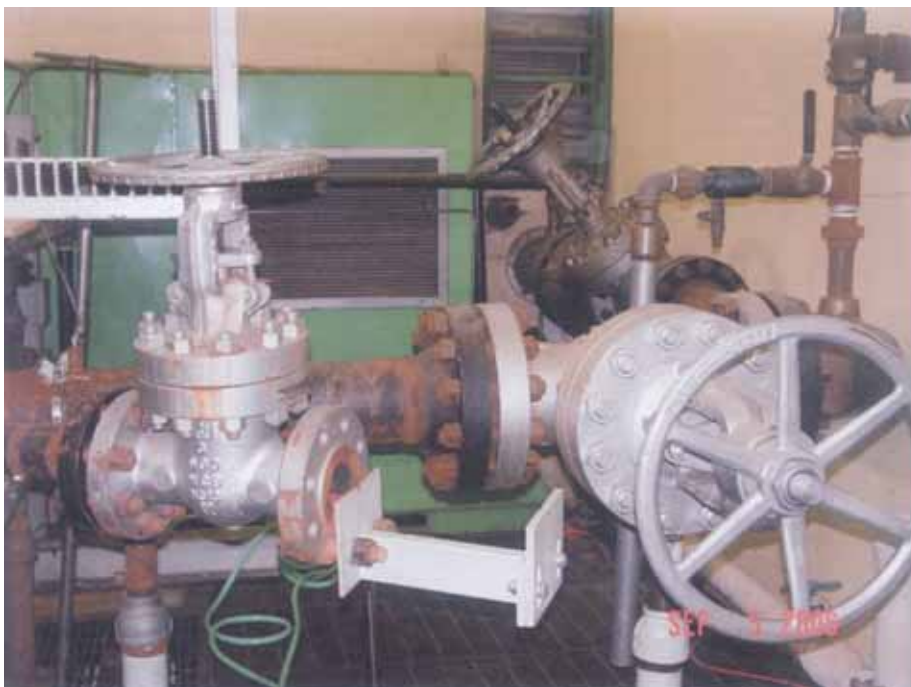
蒸汽出口管路與閥門
