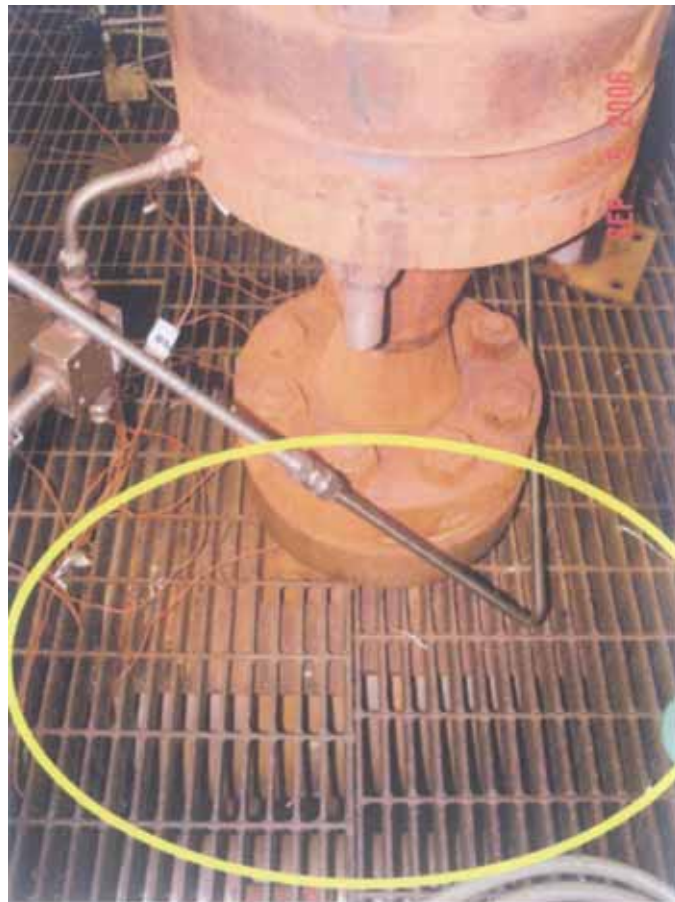
蒸汽蓄壓槽 （小型，在隔板下方）
