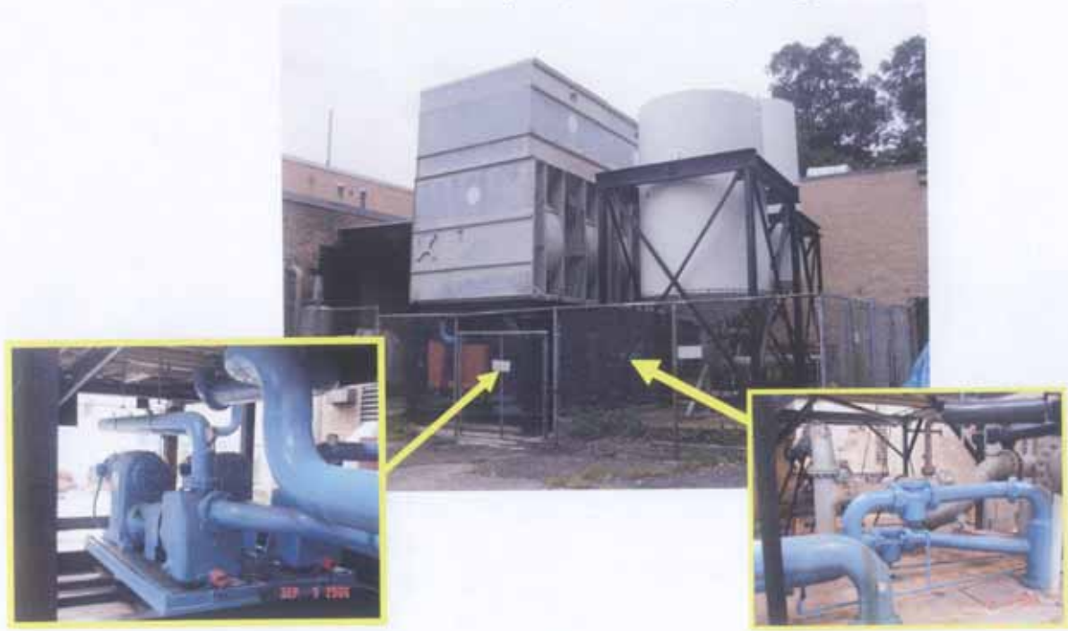
屋外大型冷卻水塔、冷卻水泵與管路
