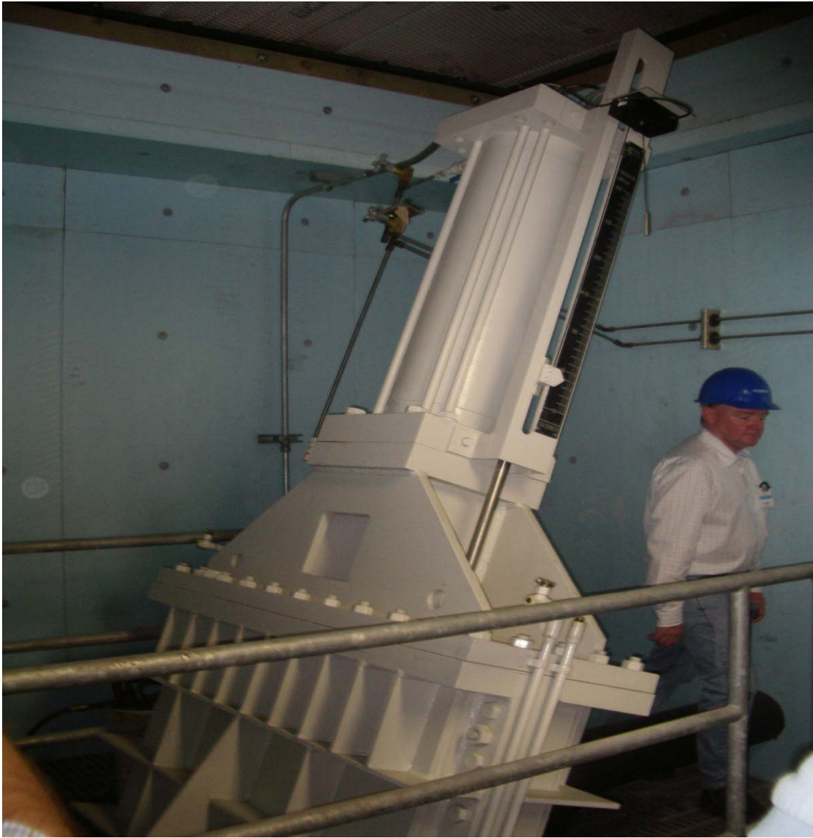
照片 11 JORDENELLE DAM 出水工閘門控制
