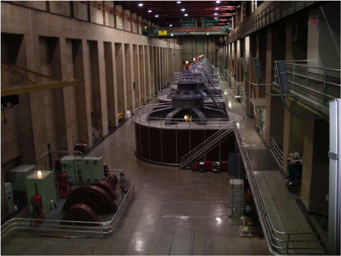
照片 33 HOOVER DAM 發電機
