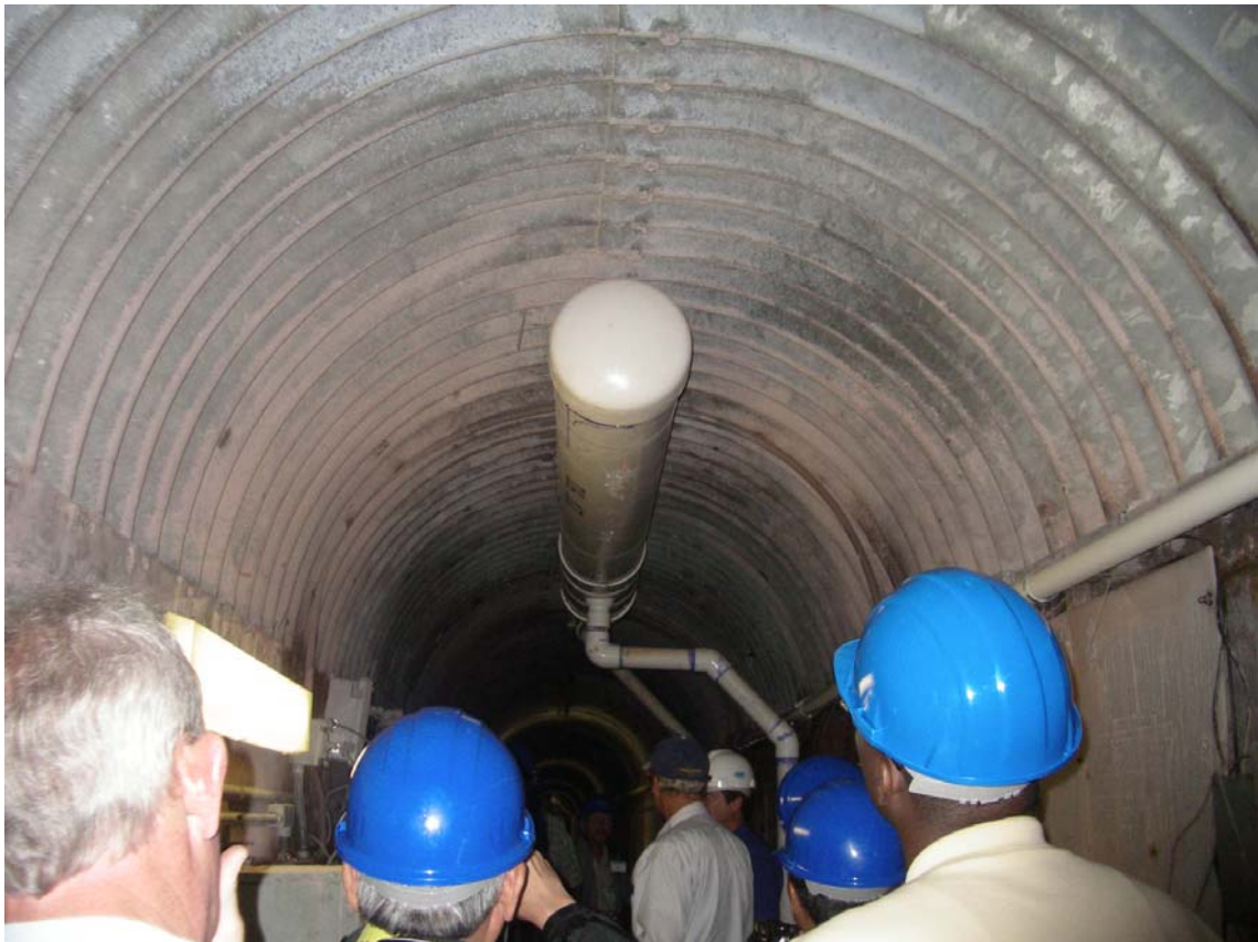
照片 25 UPPER STILLWATER DAM 廊道內部集水設備
