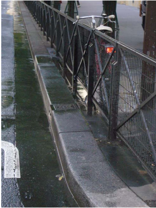
巴黎 D' lyon 車站附近道路緣石內設水龍頭，可清洗路面及澆水。【3-13】
