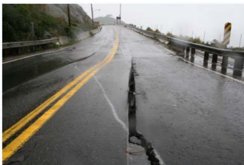
圖 3 魔鬼坡 2005 年災損情形
