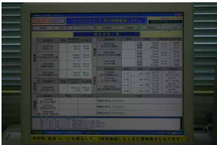
相片 24 防災監測控制系統
