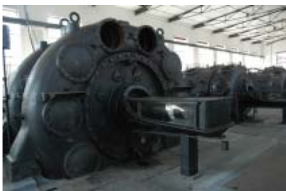
有著五座巨大瓦斯壓縮機的引擎室
