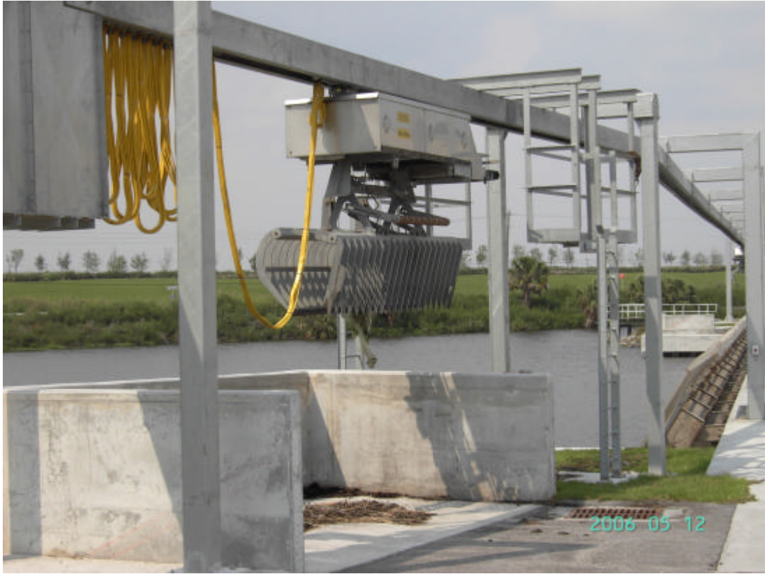
圖4-8 水面浮木等物清除設備
