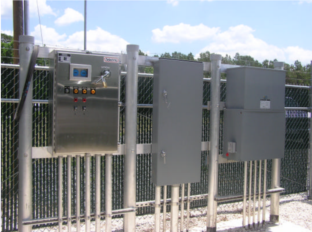
圖4-15 抽水控制設備
