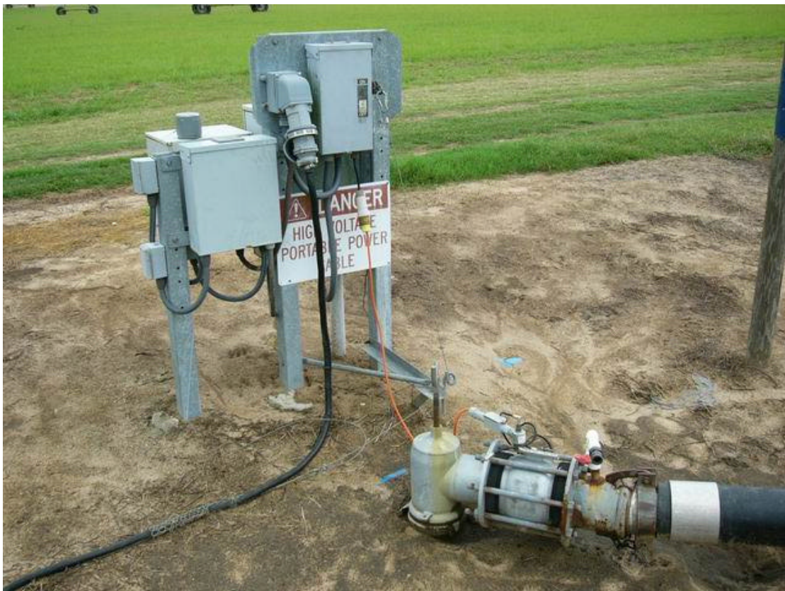
圖3-11 Liner Pivot供水及供電設施
