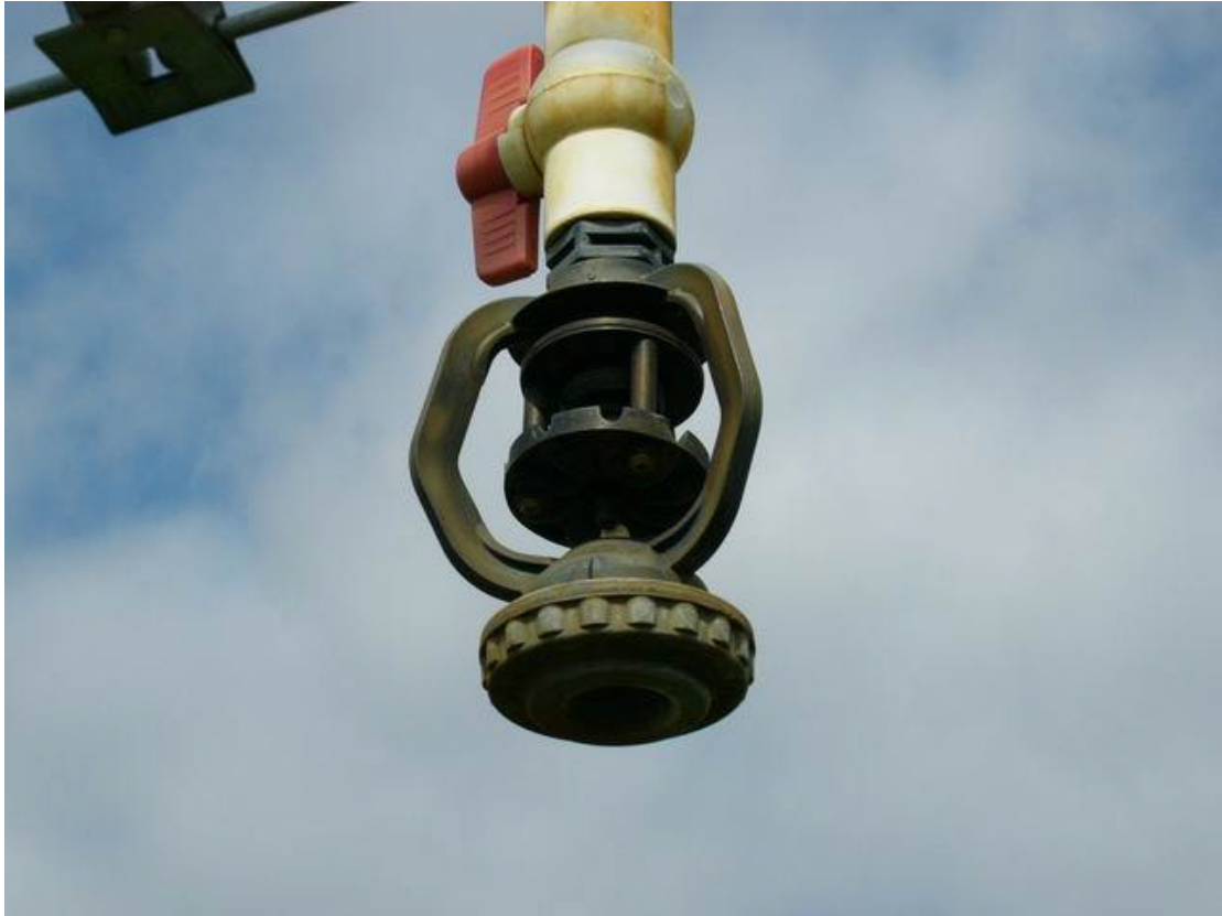
圖3-12 Liner Pivot灑水噴嘴
