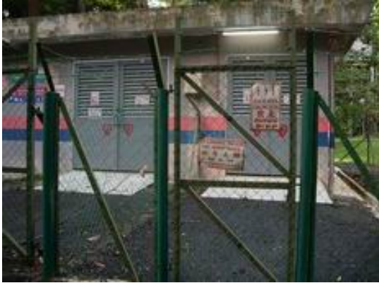
研究站內自 2005 年完成電力設備
