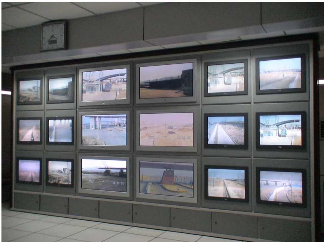
圖 61 大連港保稅物流園區中控室
