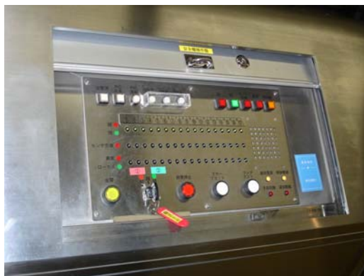
月台閘門開關操作板
