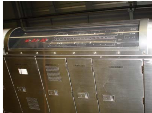
月台閘門開關顯示板
