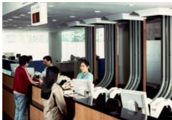
一樓借還處，電腦輸送系統可直接把歸還的書籍運送至各樓層分類上架。
