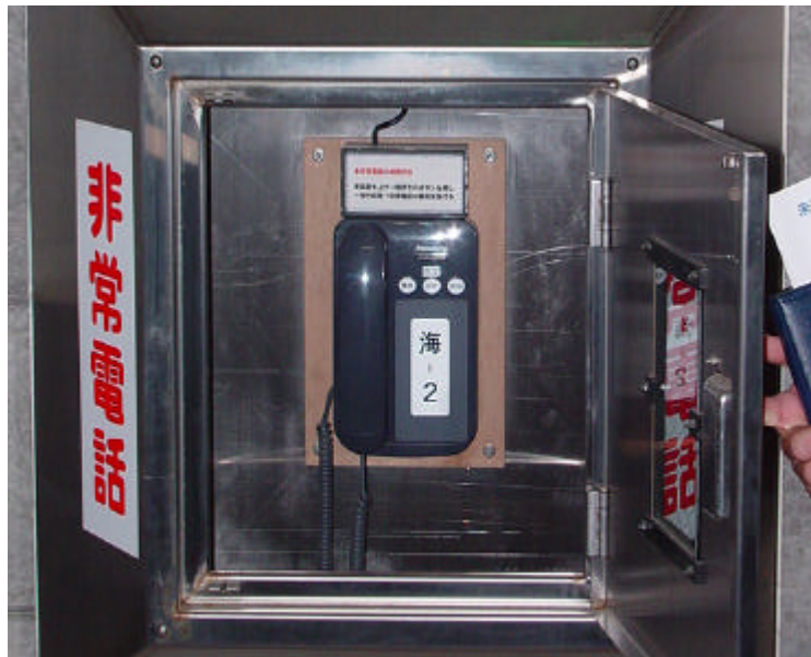
圖 4-8-4：新潟港灣隧道之緊急電話
