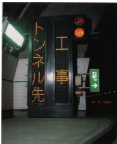
隧道內情報看板
