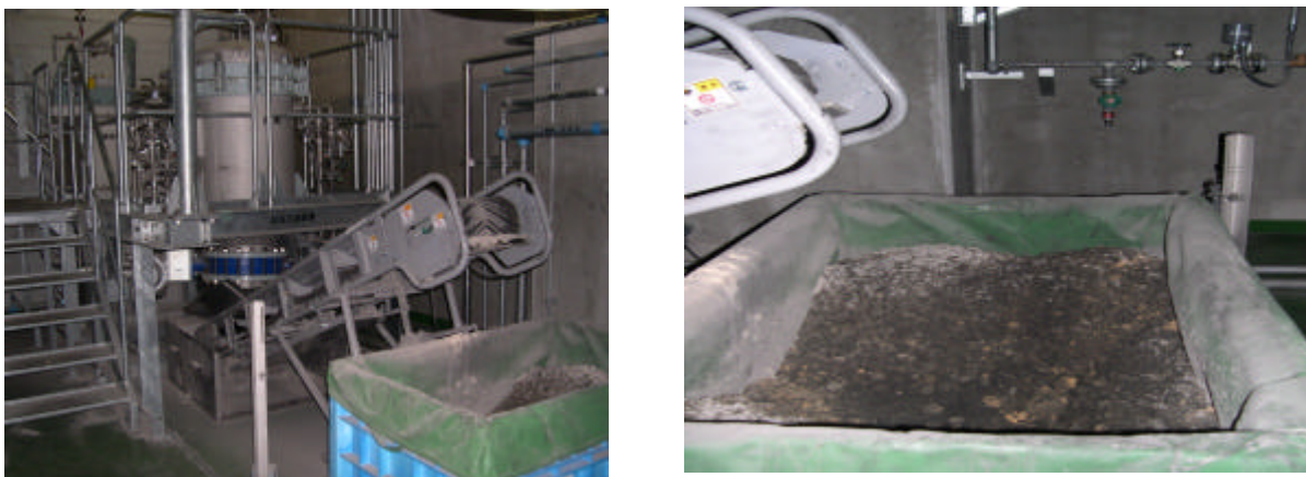
圖 4-7-3：新神戶隧道之除塵裝置過濾後收集之粉塵
