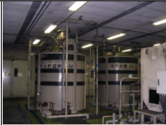
圖 4-5-14 污水處理設備
