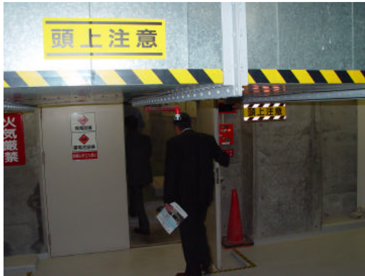
圖 4-6-9：新潟港灣隧道機房警示設施
