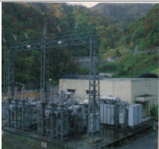
水上側特高變電所
