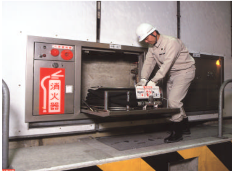
圖 4-1-2：日本關越隧道輪盤圓管式消防栓箱
