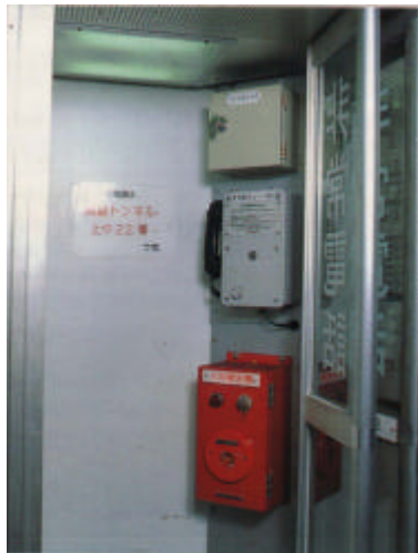
緊急電話、手動通報機
