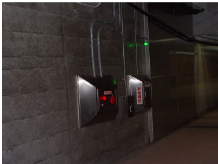
圖 4-6-8：新潟港灣隧道內之自行車道及人行步道之緊急電話及火警報知器
