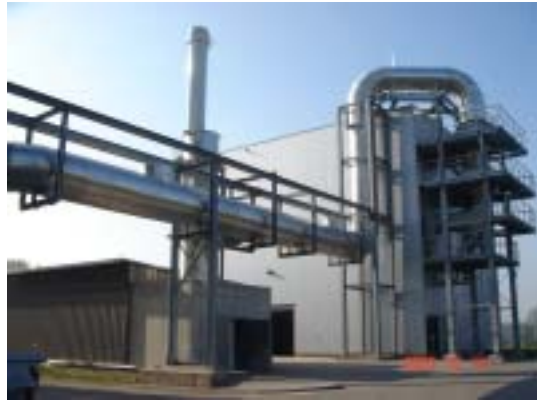
圖 38 IDF 實驗室環保廢氣處理設施
