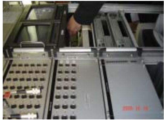
圖 31 IDF 戶外偵測車內分析設備
