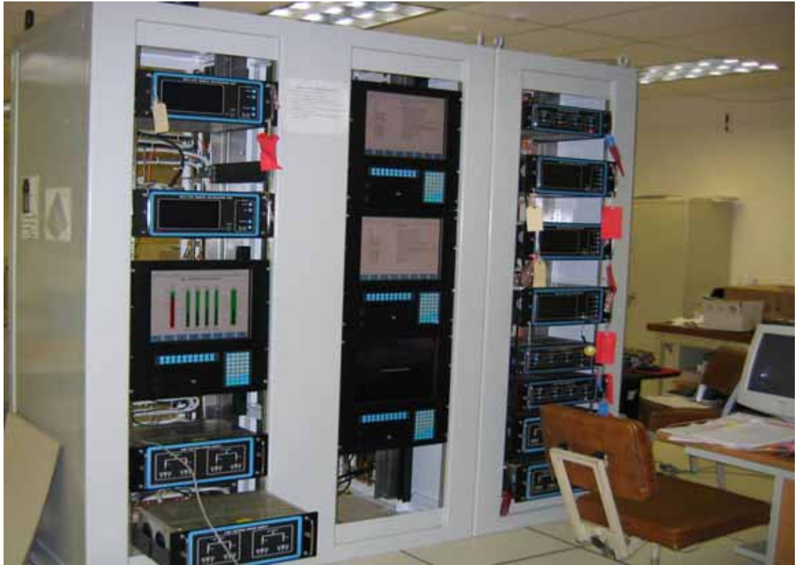
圖五 RTIF 機櫃外貌與測試狀態
