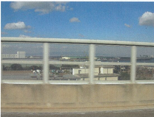
附圖五 快速道路透明隔音牆之設置
