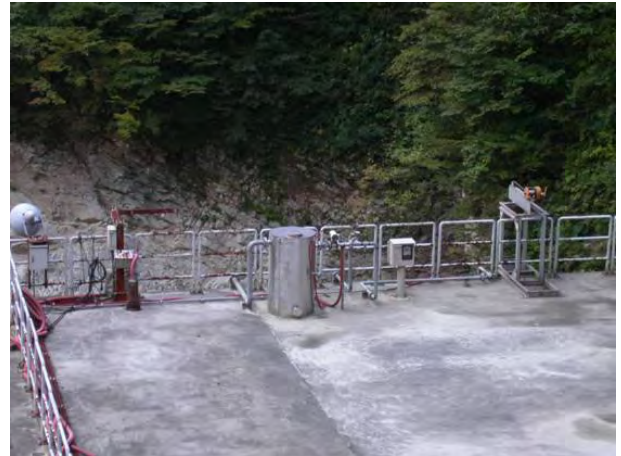
照片 034 出し平水庫-懸浮載水樣取樣設備
