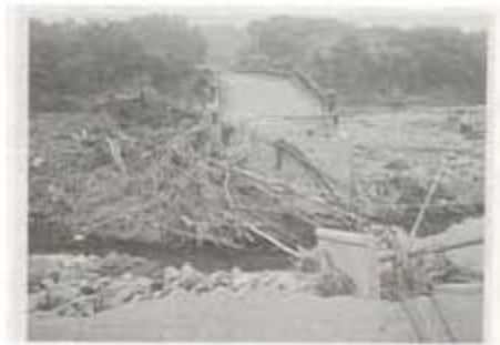
風倒木の流出により橋梁が破壊された例
