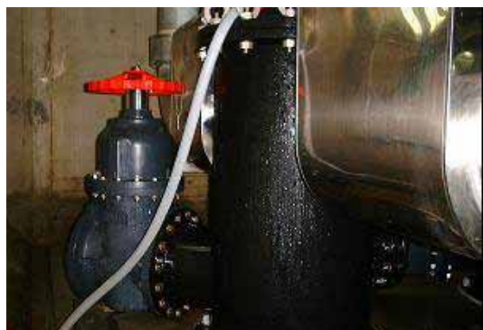
取水管與空氣接觸產生許多凝結水珠
