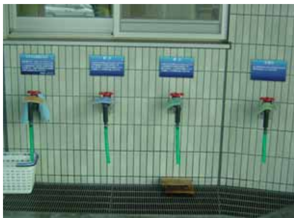
(圖 31：滑川市取水分水設施加水設備)
