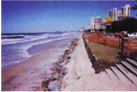
1996 年離岸淺堤(Reef)設置前，遇暴潮後海岸沖蝕
