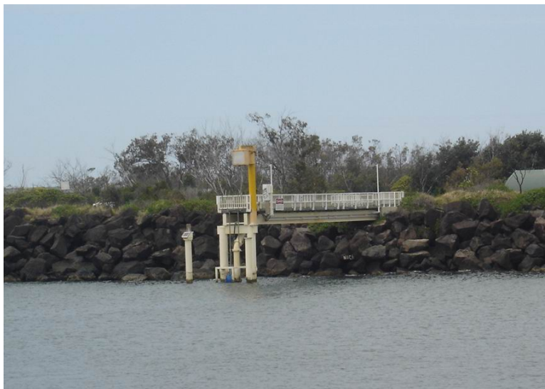
圖 16 Pumping water from Tweed River 河道南岸抽水站
