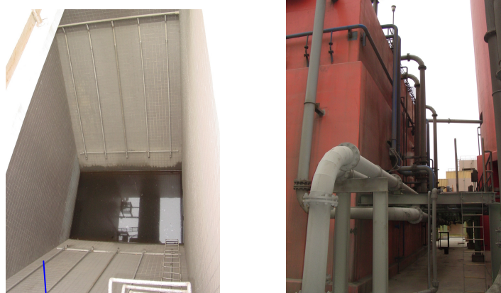
出灰轉換系統灰漿收集槽內及外觀
