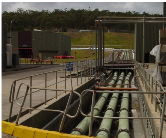
圖 9：Eraring 電廠排灰管線
