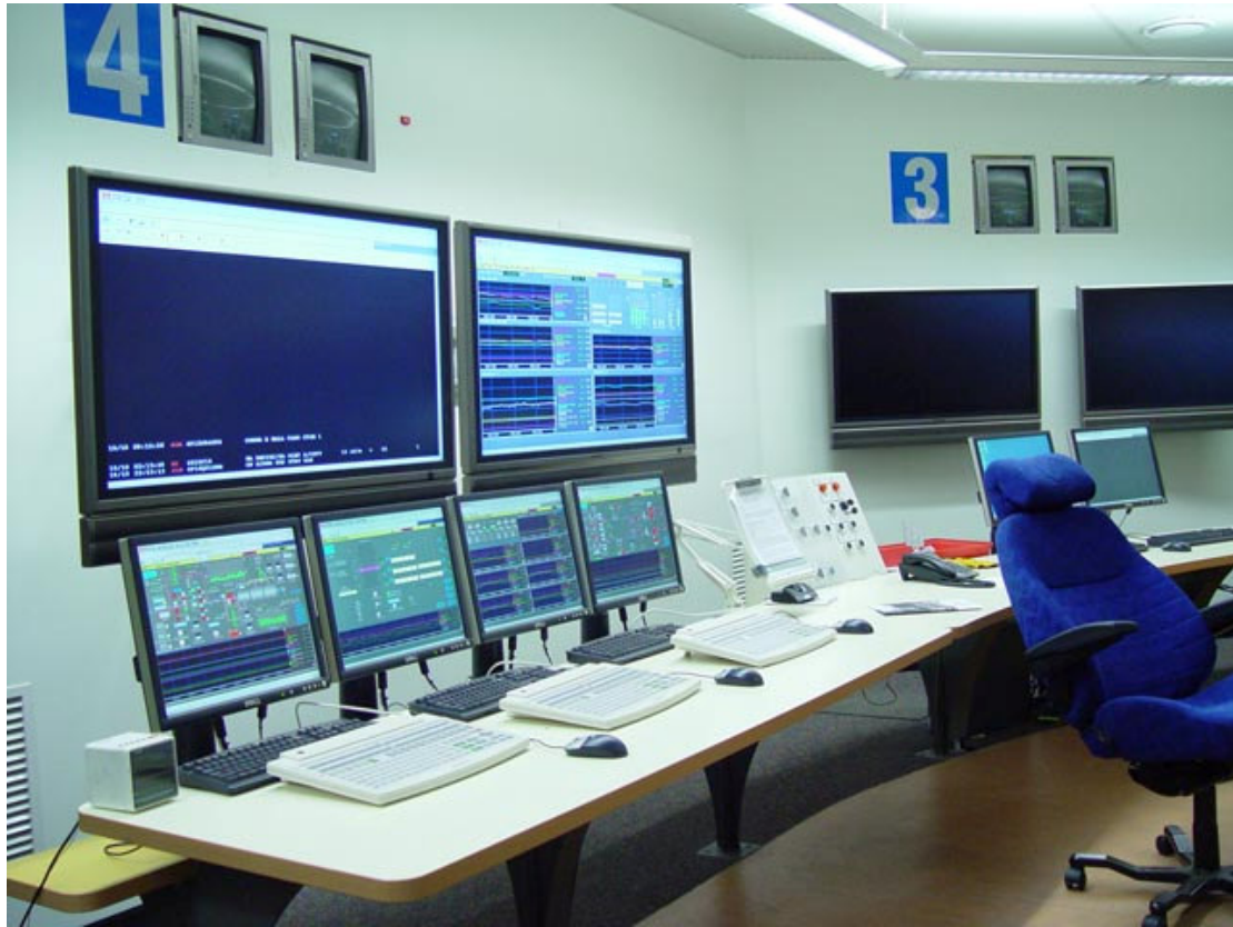
圖 2-3. Eraring 電廠新的 CS3000 DCS 控制系統
