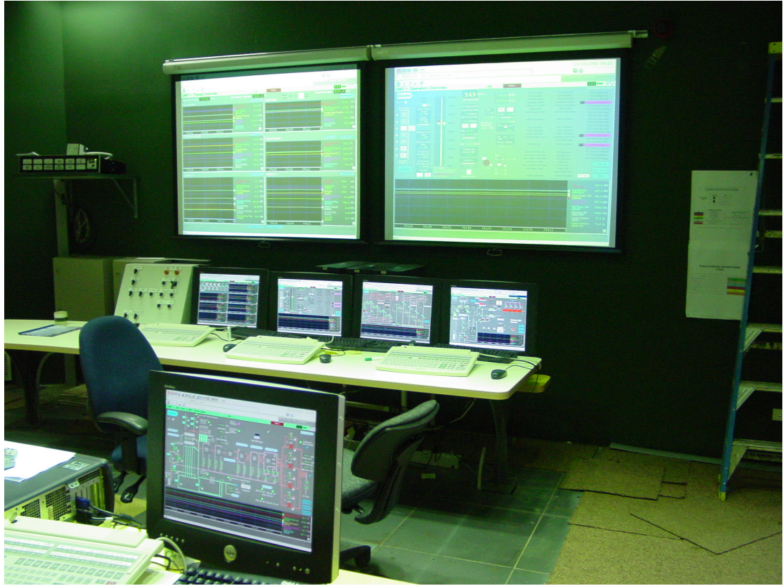
圖 2-12. Eraring 電廠委託 Yokogawa 公司更新的模擬器
