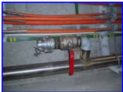
隧道區相關設施設置整齊簡單 所有管線均以吊掛方式處理不設電纜槽，方便施工及維修
