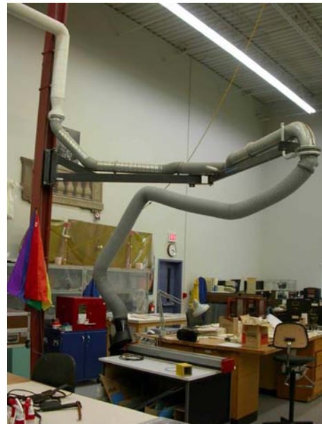
圖 30 吸塵通風設備
