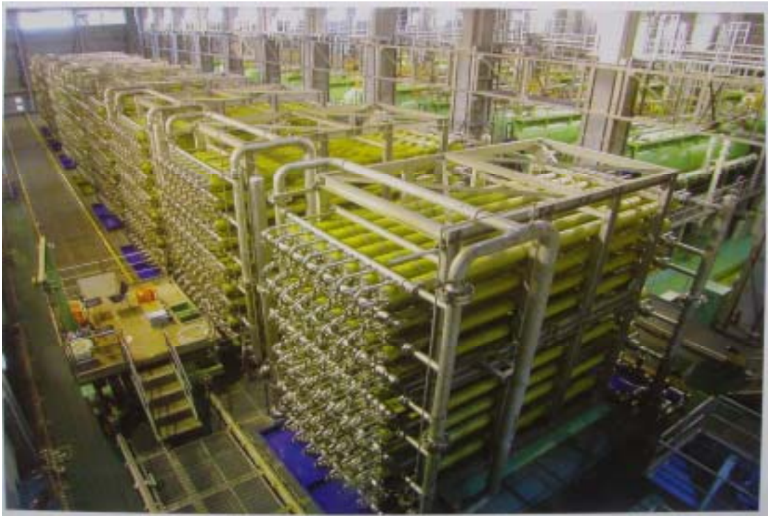
北谷海淡廠RO機組
