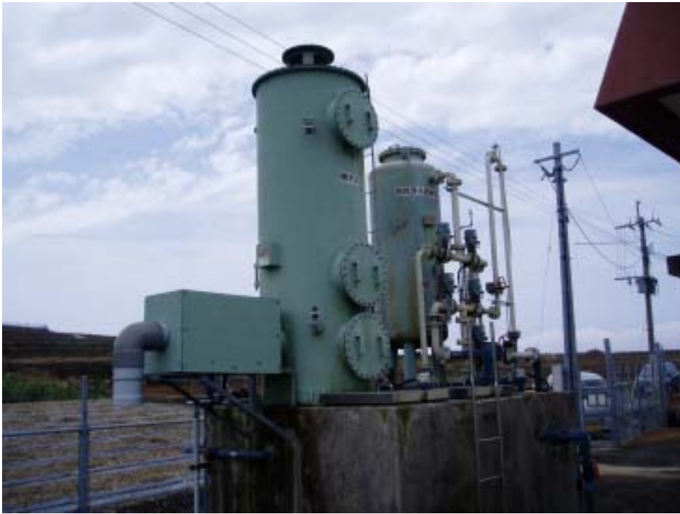
現場照片-除鐵氣曝設備
