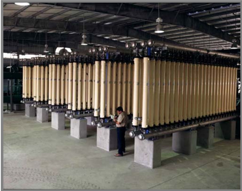
MF薄膜淨水設備模組照片（1）
