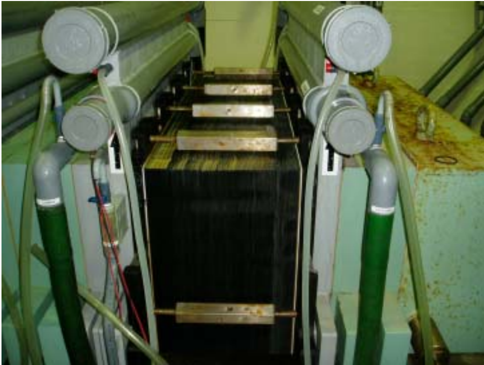
現場照片-電透析離子交換薄膜機組
