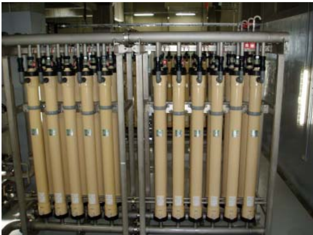
MF薄膜淨水設備模組照片（2）
