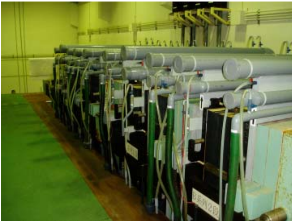
現場照片-電透析離子交換薄膜機組
