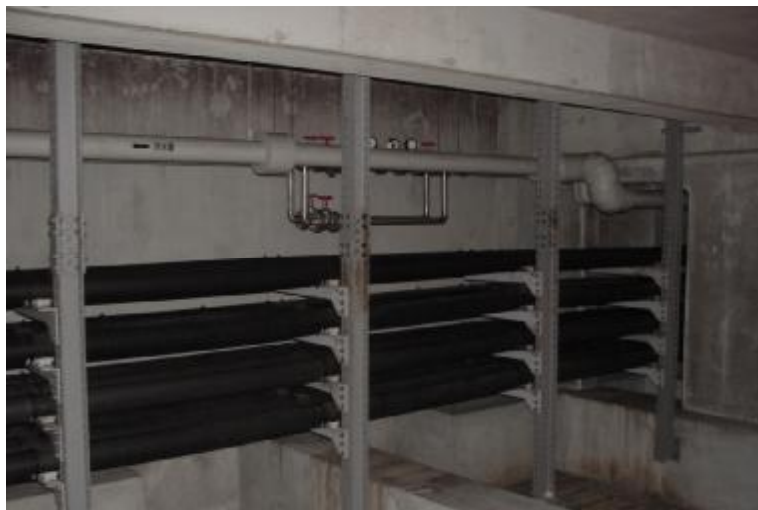
圖 4-14 聚乙烯(PE)冷卻水管
