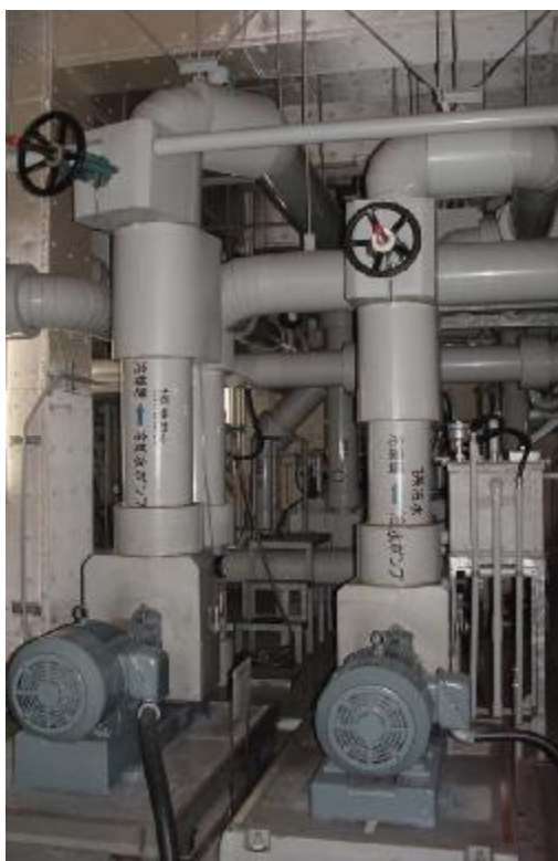
圖 4-13 冷卻水管泵浦
