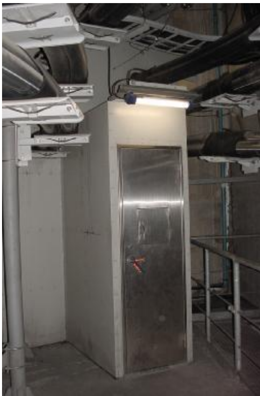
圖 4-25 洞道內通風區段分隔用之閘門(二)
