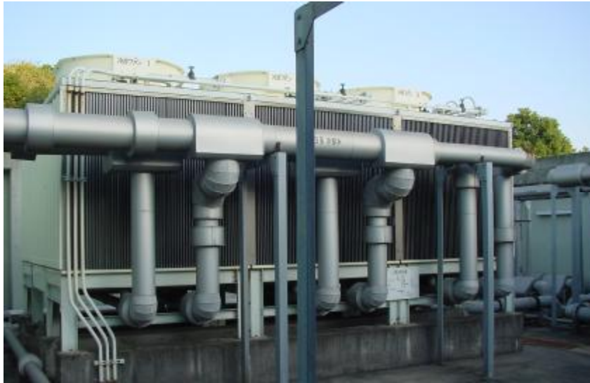
圖 4-11 密閉式冷卻水塔
