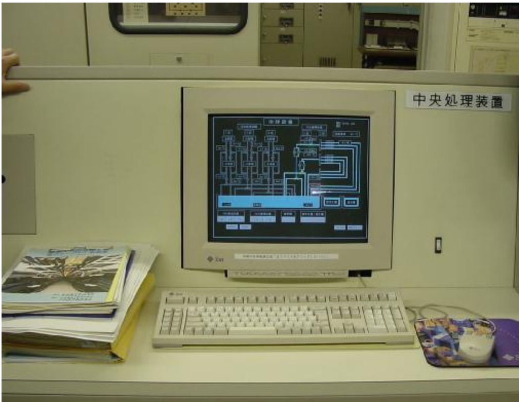
圖 4-23 洞道內及冷卻機房冷卻系統電腦監控系統
