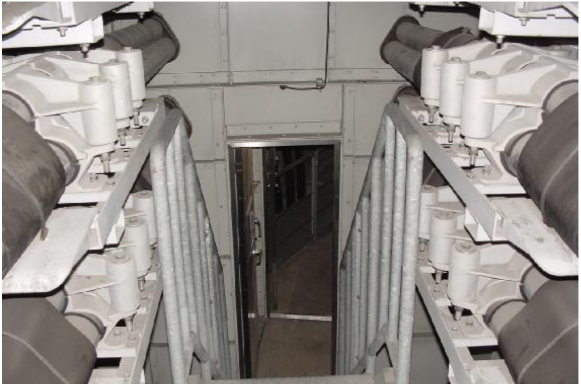
圖 4-24 洞道內通風區段分隔用之閘門(一)
