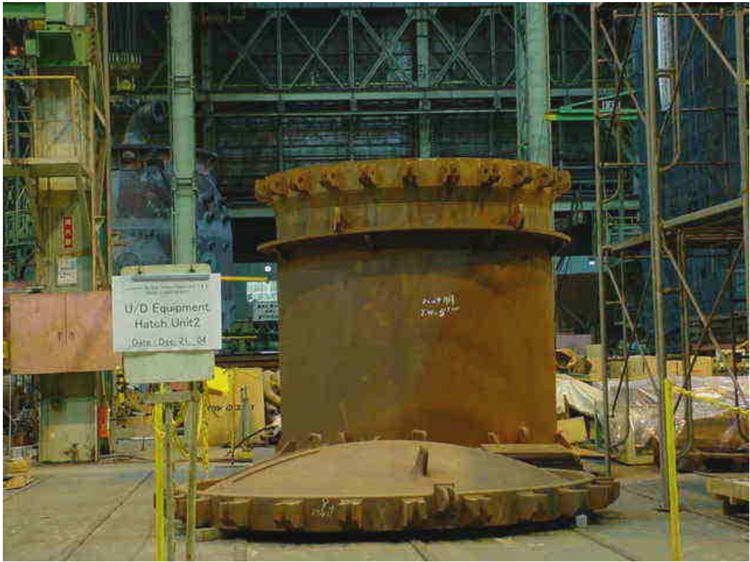
上乾井設備通道(UD Equipment Hatch)
