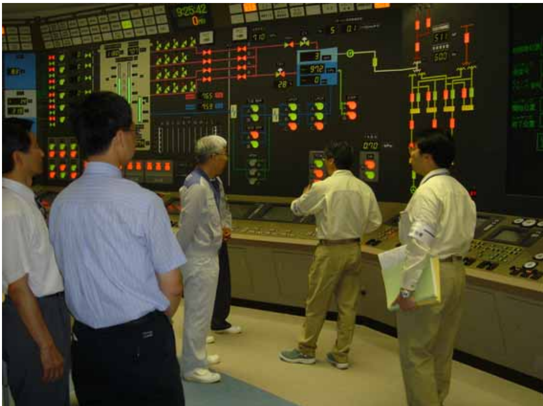
志賀電廠人員介紹操作盤面情形
