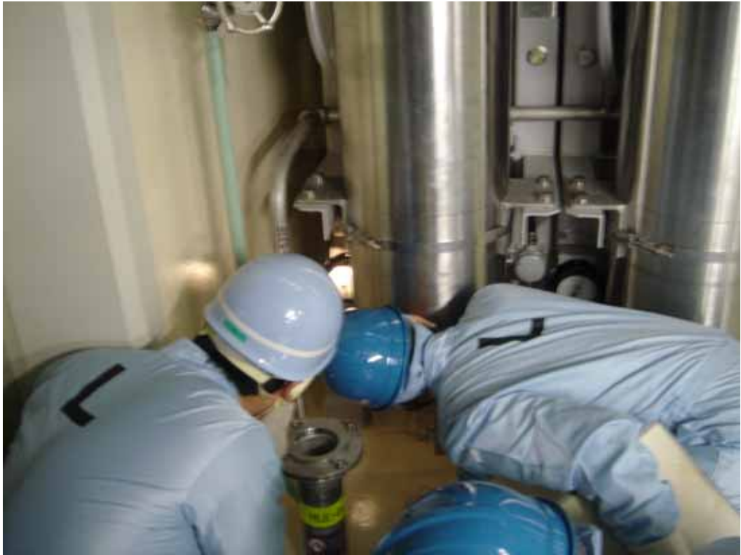
檢查人員於 HCU Room 查驗 HCU 氮氣蓄壓器壓力表編號情形
