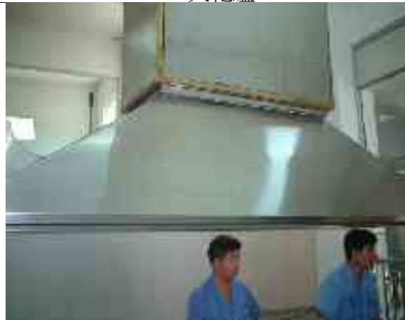
火化爐散熱台
