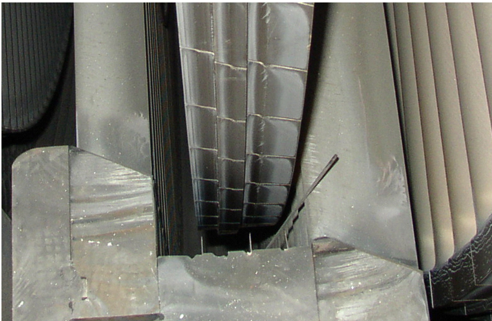
圖四、汽封片脫落情形。
