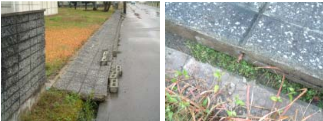
圖 2-9 內水面水產試驗場圍牆倒塌
