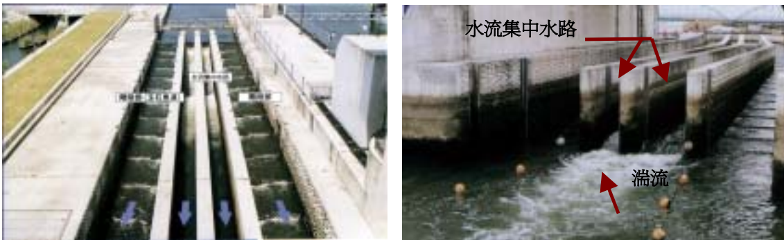
圖 3-6：集中水流式階梯魚道及其水路出口之湍流
