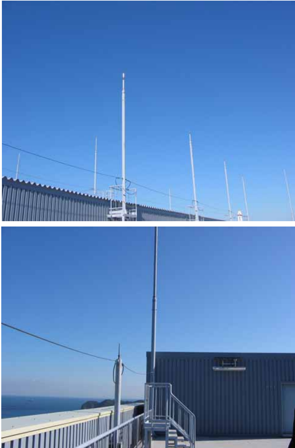
圖26 橘灣發電廠屋頂避雷針
