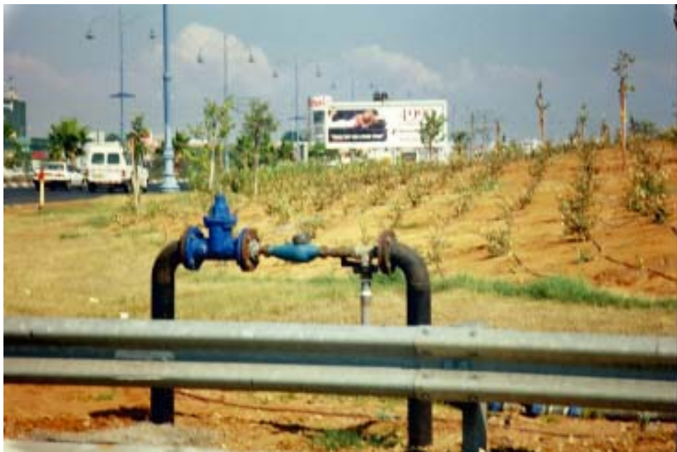
地下皆埋藏著附監測設備的供水管線嚴密禁止漏失
